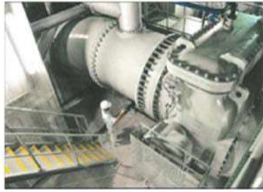
雨水ポンプの整備
