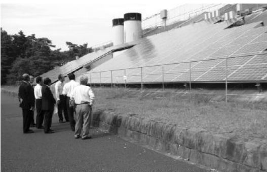
▲つくばセンター発電設備
