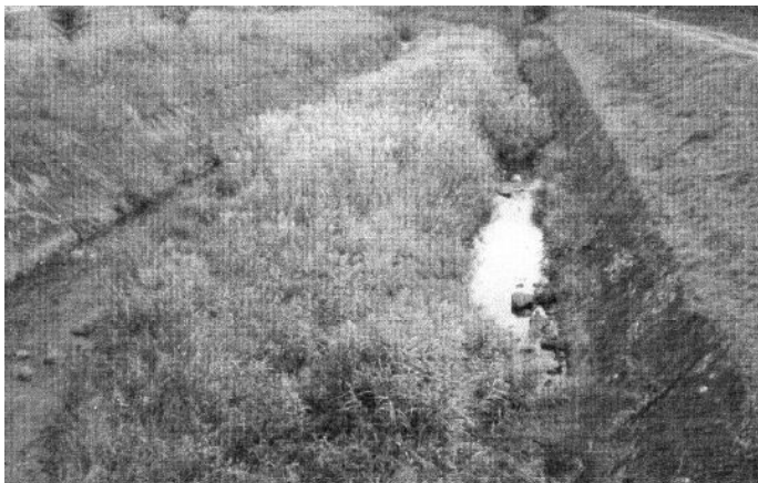
土砂の堆積した河川
