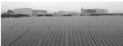
▲東京湾のメガソーラー発電所
