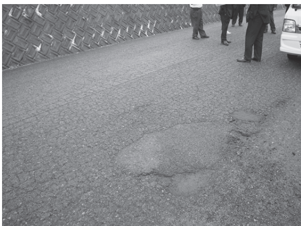
▲ 経年劣化によりひび割れが激しくなっている道路。穴があいている箇所も複数あった。
