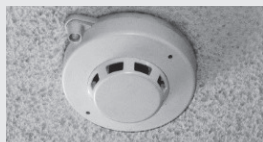
自動火災報知設備の感知器付近
