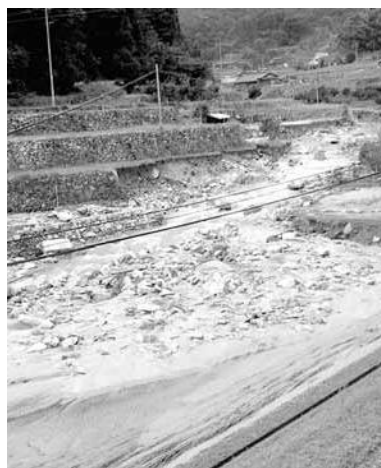
▲護岸決壊が連続する砂防河川根の谷川(南方畑地区)
