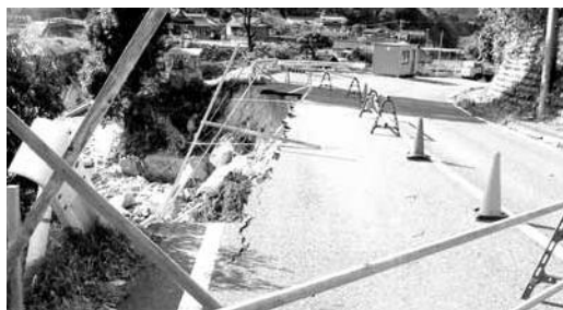
▲国道261号被災箇所内の一箇所
