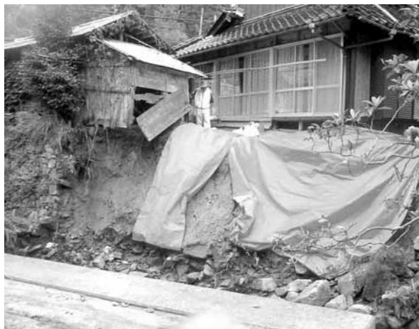
▲基礎部分が流失した宅地(南方畑地区)
