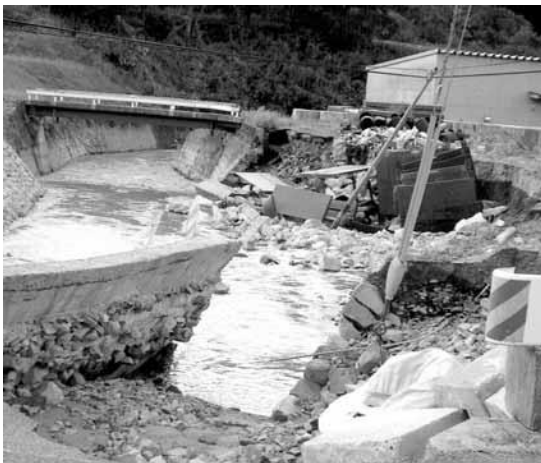
▲一級河川出原川(木次地区の護岸決壊)
