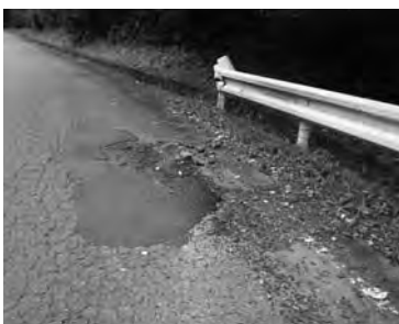
舗装破損した町道
