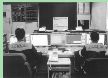
▲消防署指令室
