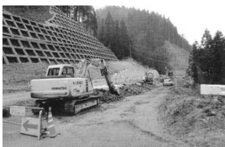
▶ 国道433号塩明入口付近
