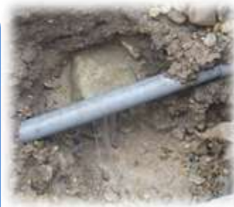
老朽化した 水道管からの漏水
