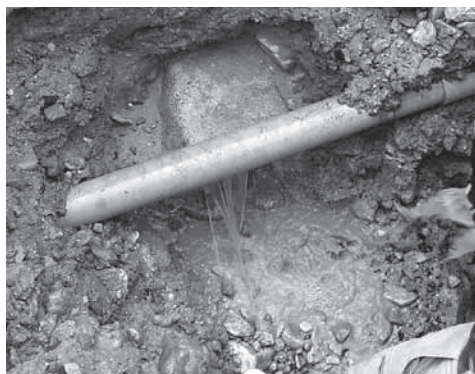
老朽化した水道管からの漏水
