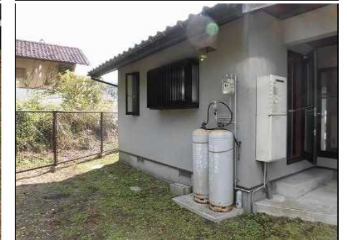
ガスボンベ設置状況
