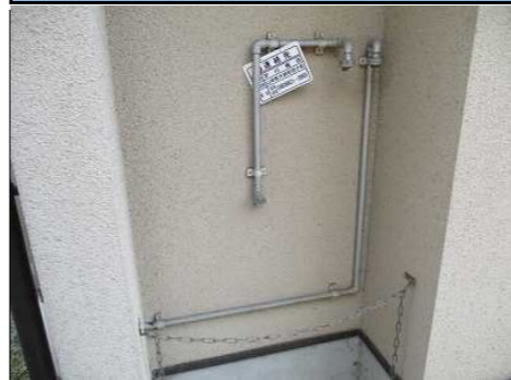
ガスボンベ置き場
