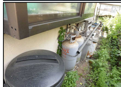
ガスボンベ置き場
