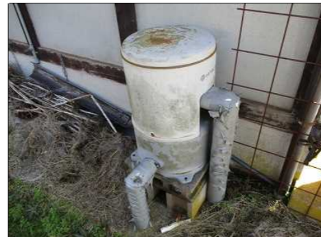
井戸ポンプ設置状況 (故障)
