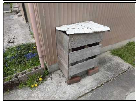
ポンプ設置状況
