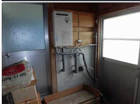
ガス給湯器設置状況
