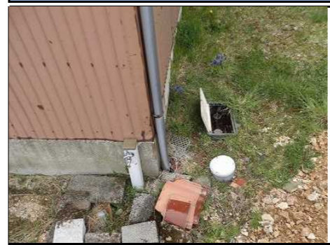
止水栓 水洗柱
