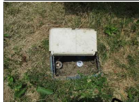
町水道引込 止水栓
