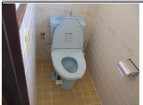
2階トイレ簡易水洗
