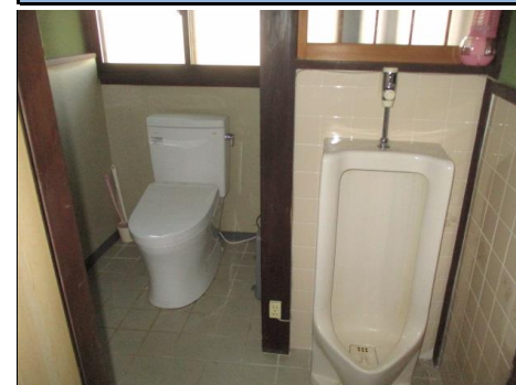
1階トイレ 水洗
