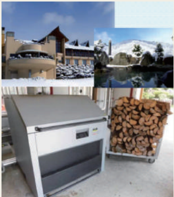
芸北オークガーデンの薪ボイラー
