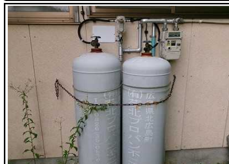
ガスボンベ設置状況
