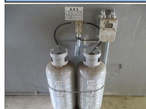
ガスボンベ置き場
