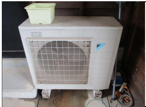
エアコン室外機
