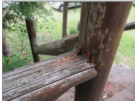
手すり 腐朽状況
