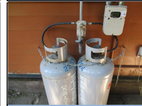
ガスボンベ設置状況
