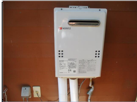
給湯器設置状況
