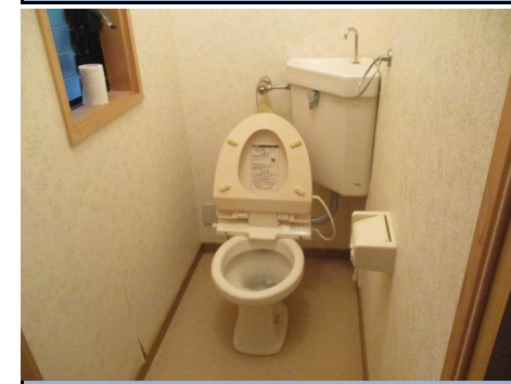
別棟トイレ水洗
