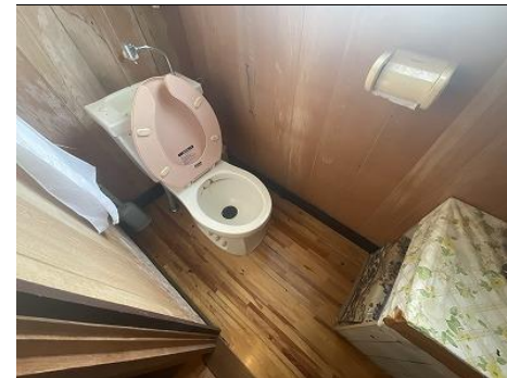
トイレ簡易水洗
