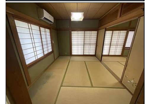
和室 エアコン設置状況
