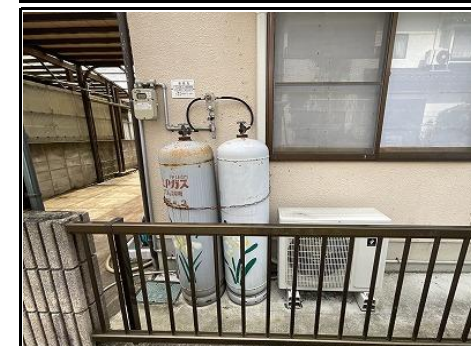
ガスボンベ・室外機
