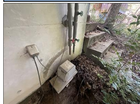
浄化槽 ブローア
