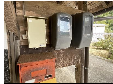
メーター設置状況
