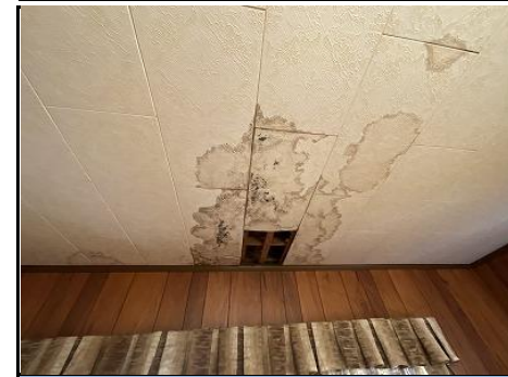
天井一部修繕要
