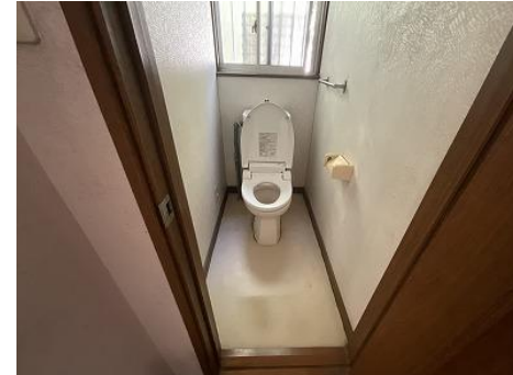
1階トイレ水洗
