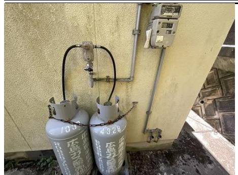
ガスボンベ設置状況
