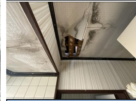
台所天井雨漏り (西側)
