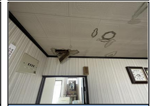
台所天井雨漏り (東側)
