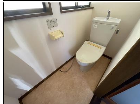
2階トイレ水洗
