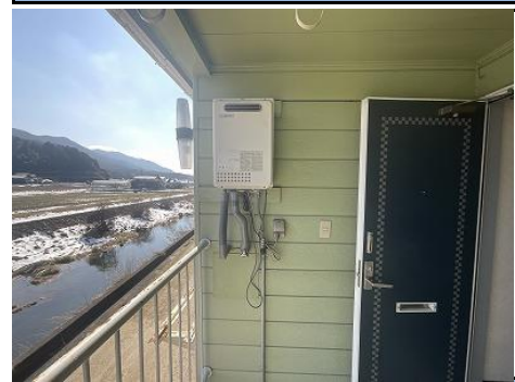
給湯ボイラー
