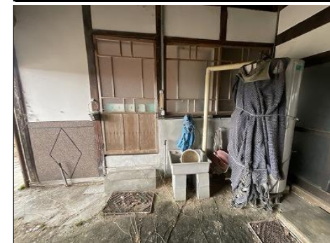
通路 温水器設置状況
