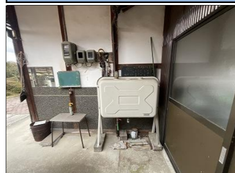
灯油設置状況
