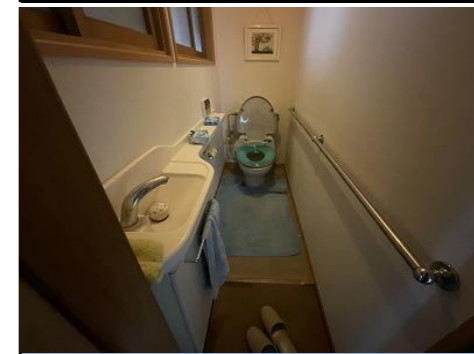
1階トイレ水洗
