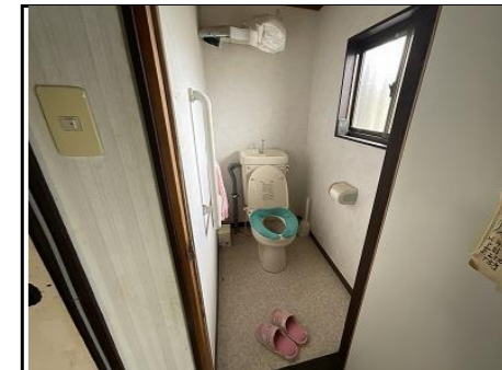
南西側トイレ 水洗
