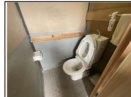
北東側トイレ 水洗
