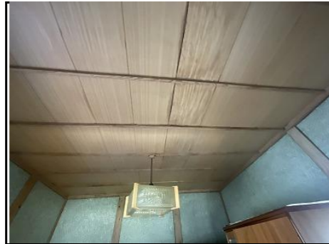
2階 和室6帖 雨漏り跡
