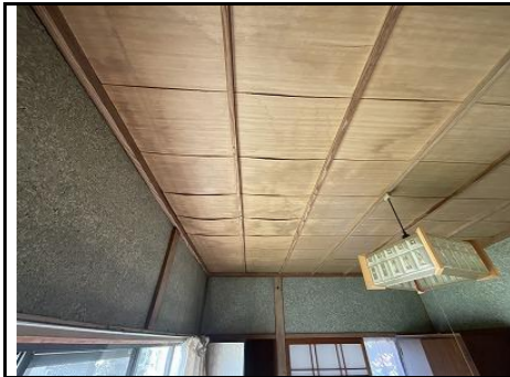
2階 和室6帖 雨漏り跡
