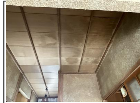
2階 和室6帖 雨漏り跡
