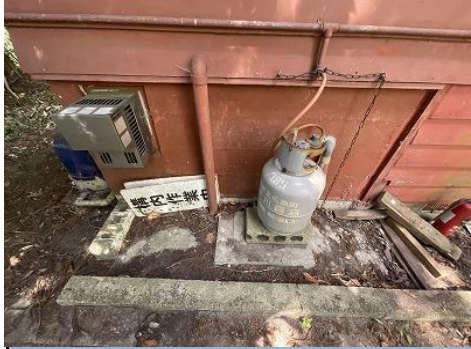
ガスボンベ設置状況
