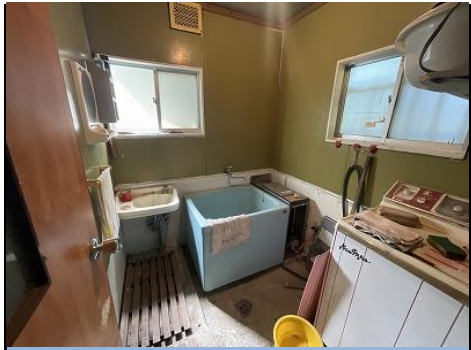
浴室 ガスバランス釜
