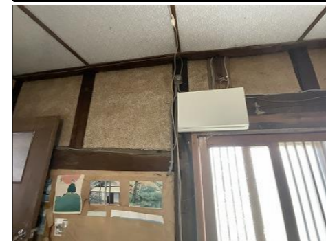
ブレーカー設置状況
