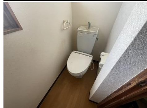
トイレ水洗③
