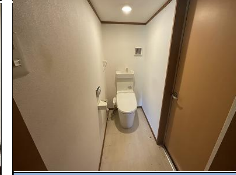
トイレ水洗①
