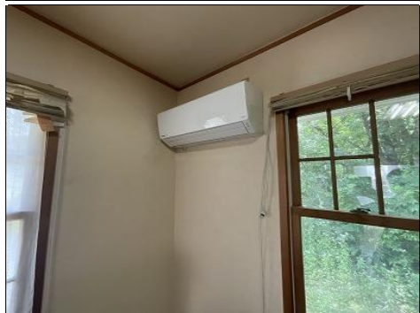
エアコン設置状況
