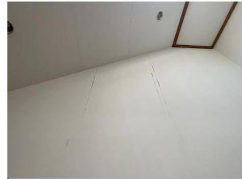
天井 壁紙 劣化状況
