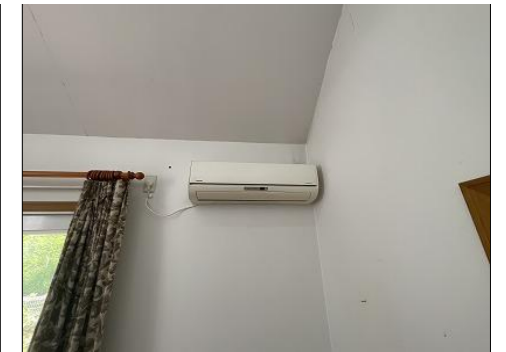
エアコン設置状況
