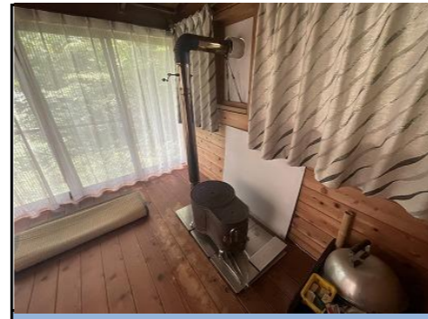
薪ストーブ設置状況
