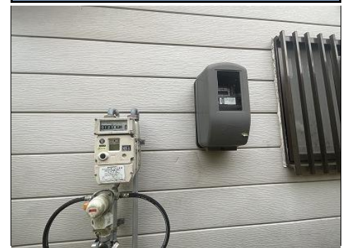
ガスメーター・電力計メーター設置状況
