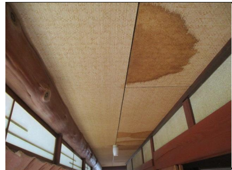
縁側天井状況
