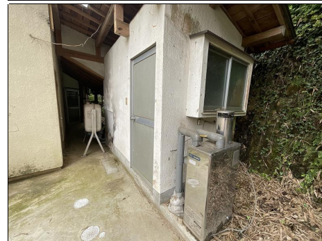
灯油ボイラー設置状況
