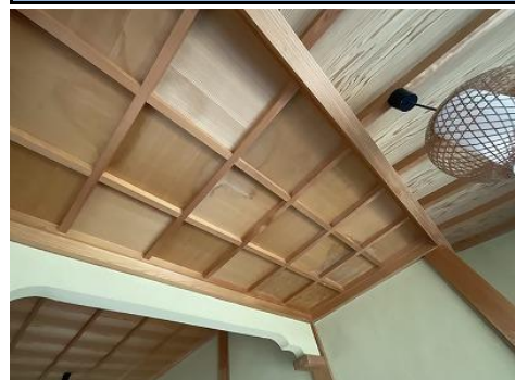
別棟 茶室 雨漏り跡
