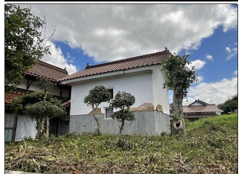
土蔵 漆喰剥離
