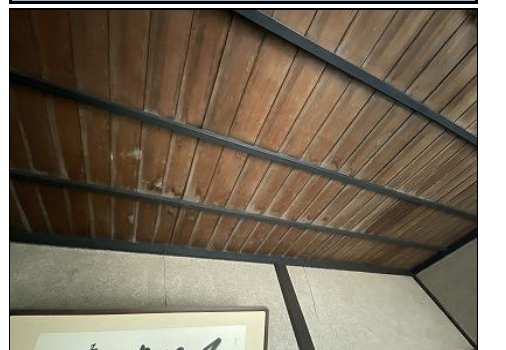
客間 雨漏り跡
