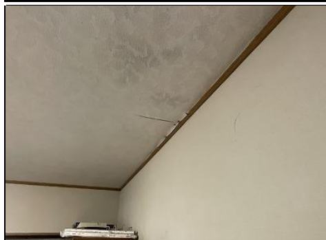
洋間 雨漏り跡
