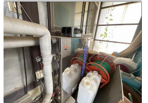
灯油ボイラー
