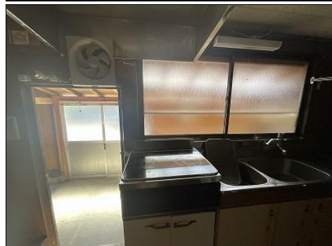
換気扇 コンロ廻り
