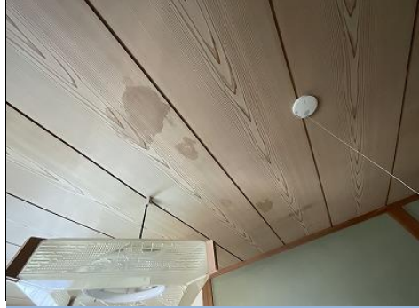
2階 和室7.5帖 天井雨漏り跡
