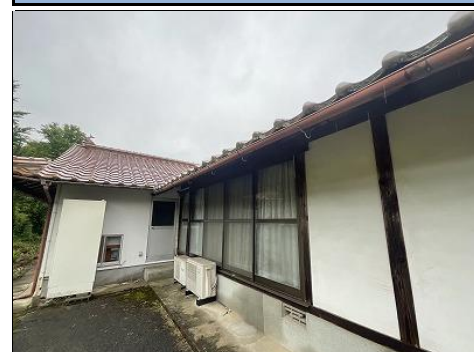
電気温水器・室外機設置状況
